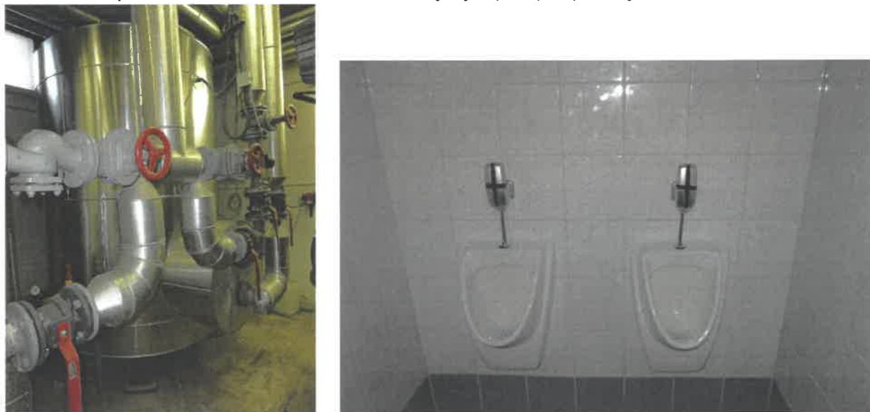
Slika 30: Priprava STV v dveh kombiniranih bojlerjih (levo) in pisoarji z EMV ventili (levo)
